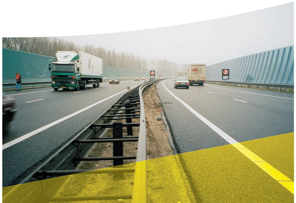
Verouderd constructietype geleiderail in de middenberm
